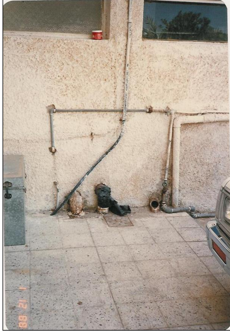
شكل (٨) تآكل التمديدات في شبكة المياه
