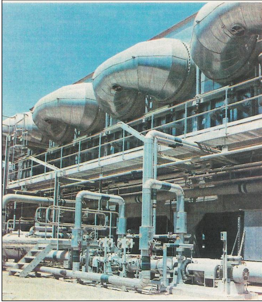
محطة لتحلية مياه البحر ومياه نقية وصحية
