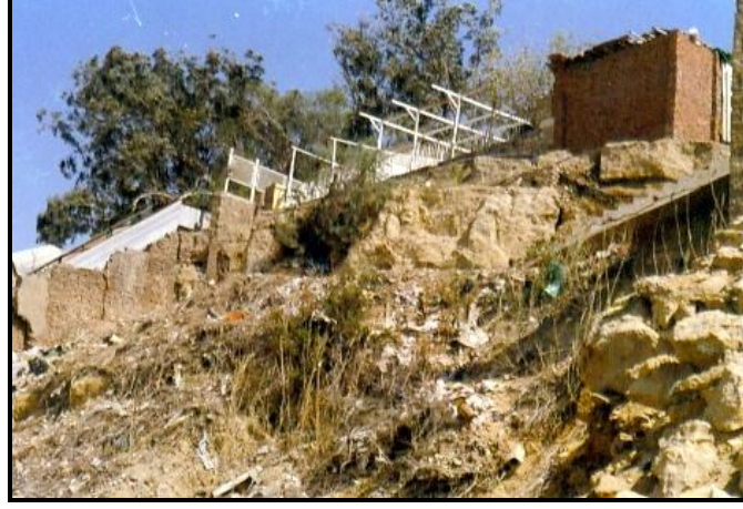
صورة (٩): انهيارات للمنازل المقامة علي حافة الهضبة العليا للمقطم الجنوبية بسبب تسرب مياه الصرف عام ٢٠١٤
