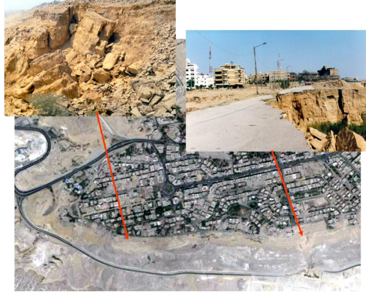
صورة (١٧): انهيار جزء كبير من طريق الكورنيش المحيط بمدينة المقطم من الجنوب
