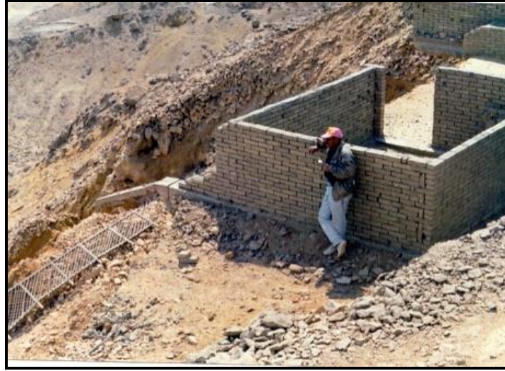
صورة (١٠): أثر انزلاق صخري قديم لمنزل تحت الإنشاء علي حافة جرف الهضبة العليا الجنوبية للمقطم بعد تراجع حافتها
